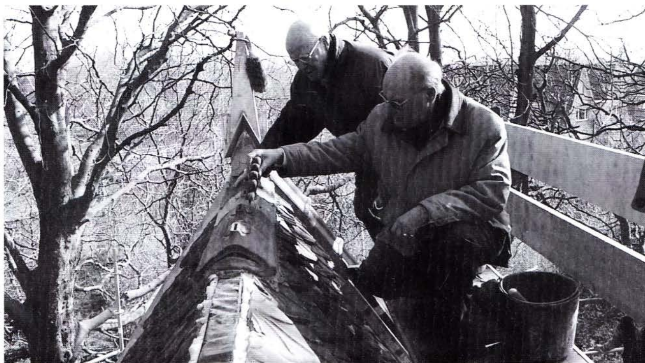
De heren Wigard en De Graaf, bestuursleden, wagen zich op het dak van de kapel op de r.k. begraafplaats aan de Drieboomlaan. Zij plaatsen 'pluimen' op de dakvorsten.
